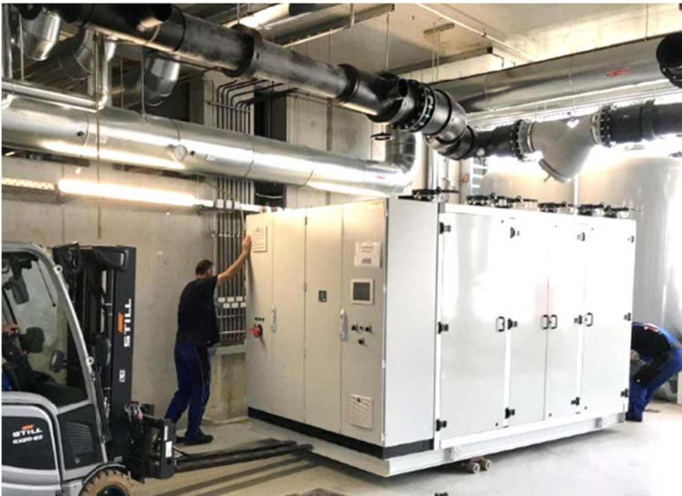
Bild 52 Aufstellung der Wärmepumpen innerhalb der Energiezentrale
