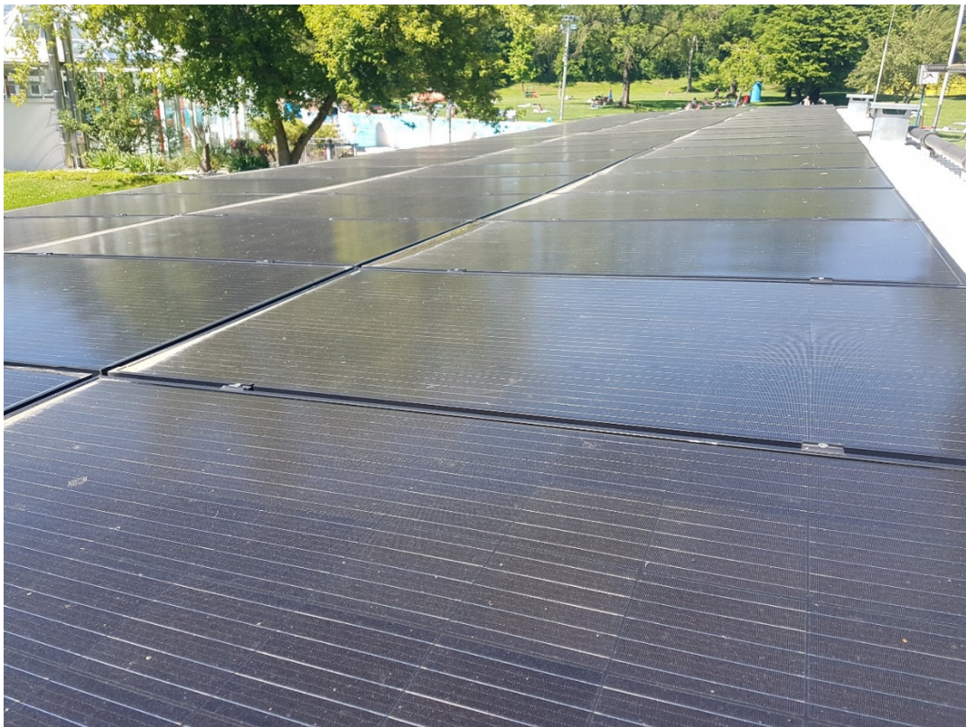
Bild 30 Hybridkollektoren (PVT) der Pilotanlage
