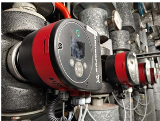
Bild 40 Hocheffizienzpumpe (Quelle: Landeshauptstadt Stuttgart)
