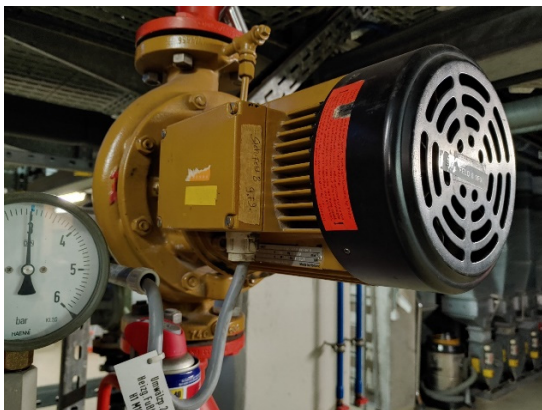
Bild 39 Ungeregelte Bestandspumpe (Quelle: Landeshauptstadt Stuttgart)
