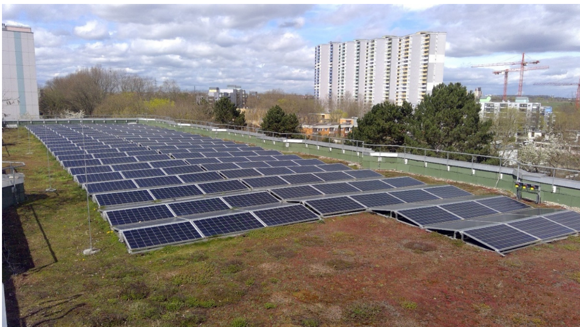
Bild 36 Photovoltaikanlage auf dem Gebäude Eschbach-Gymnasium
