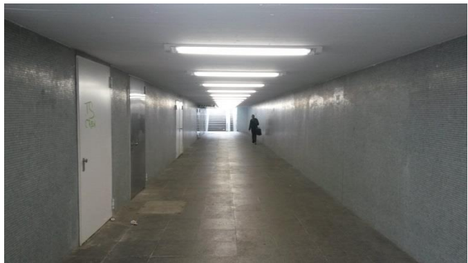
Tagbeleuchtung im Unterführungsbereich
