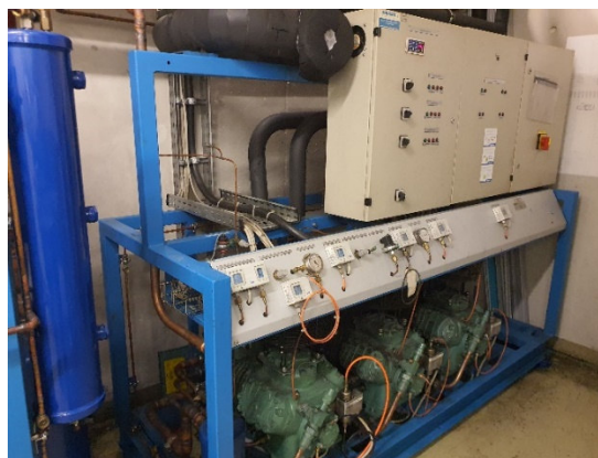
Bild 3: Kältemaschine mit Verdichter
