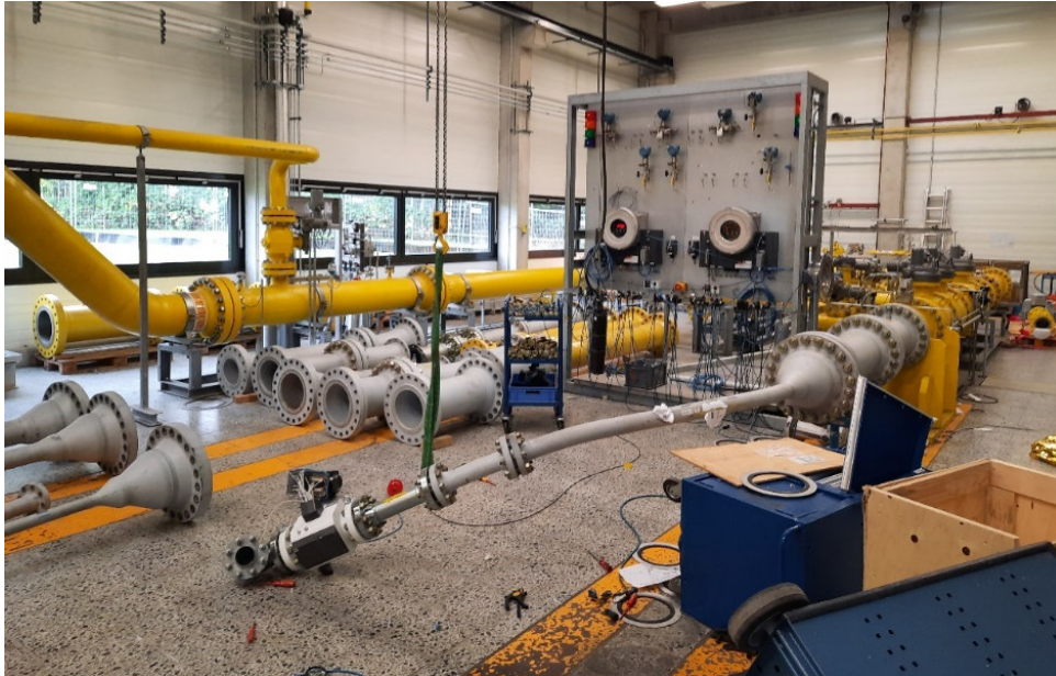
Bild 19: Blick in die Prüfhalle nach dem Unfall
