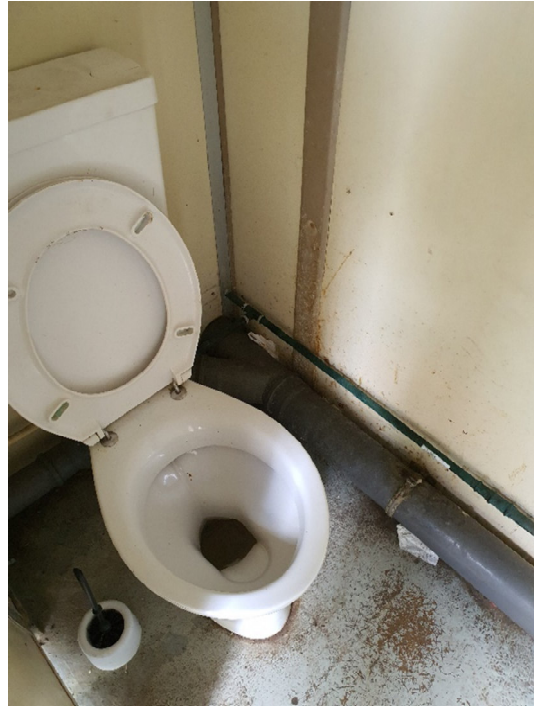
Bild 21: Nicht gereinigte sanitäre Anlagen
