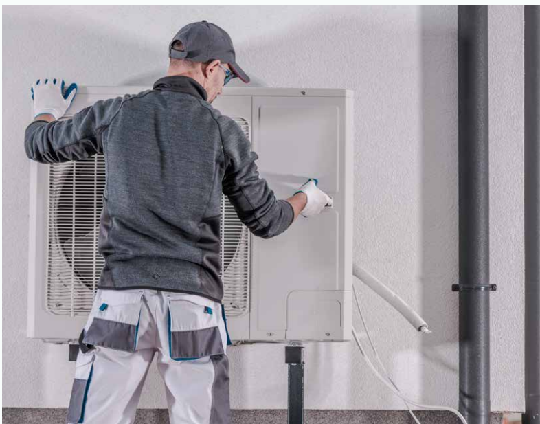
Die Wärmepumpen-Technologie nutzt die vorhandene Wärme aus der Umwelt.
