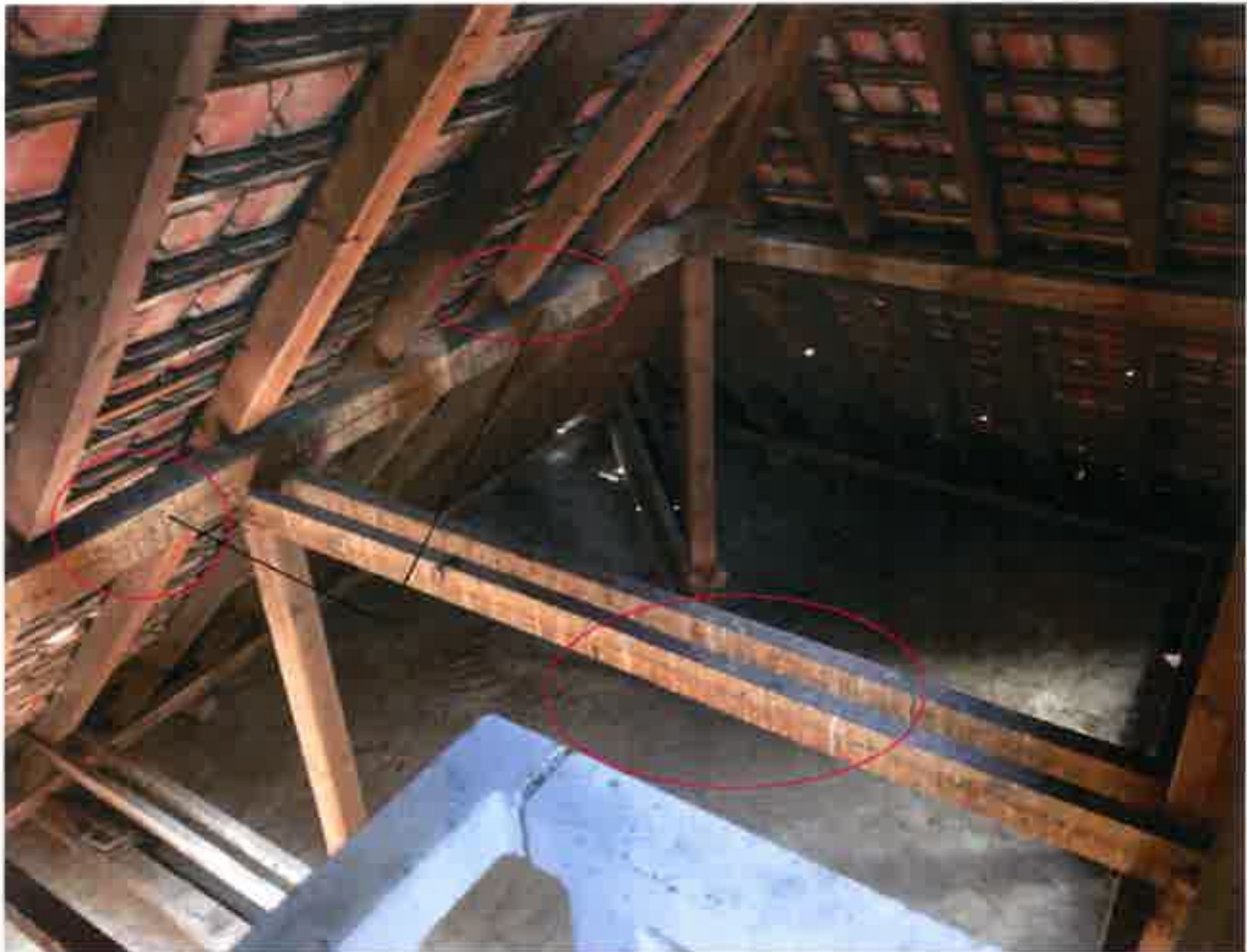
Abb. 3: An diversen Holzbalken sind typische Kotsuren, welche vermutlich von in der Vergangenheit im Dachstuhl siedelnden Stadtauben stammen, zu erkennen.
