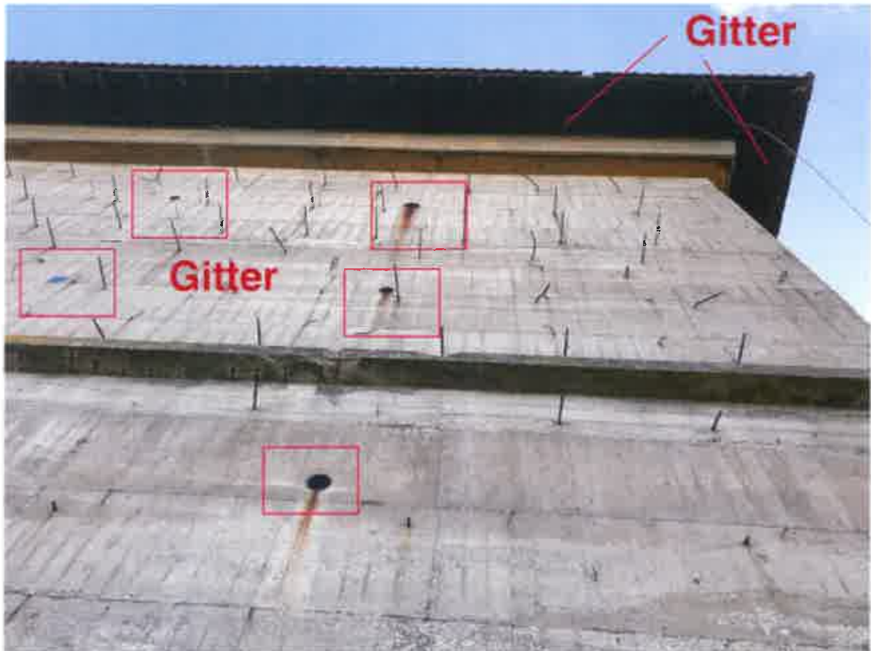
Abb. 1: Sämtliche Schachttöffnungen an der Fassade wurden durch Montage von engmaschigen Gitter verschlossen. Auch der Übergang zwischen Mauerwerk und hölzernem Dachvorsprung wurde durch eine umlaufende Installation eines Gitters gesichert.
