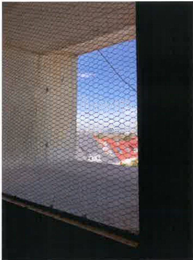
Abb. 2: Alle Fassadendurchbrüche wurden durch Montage ein engmaschiges Gitters vor eindringenden Tieren, geschützt.
