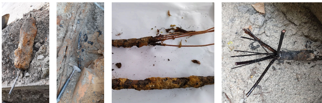
Abbildung 3.6: alte Niederspannungsmuffen, verschiedene Kabelarten und -schäden
