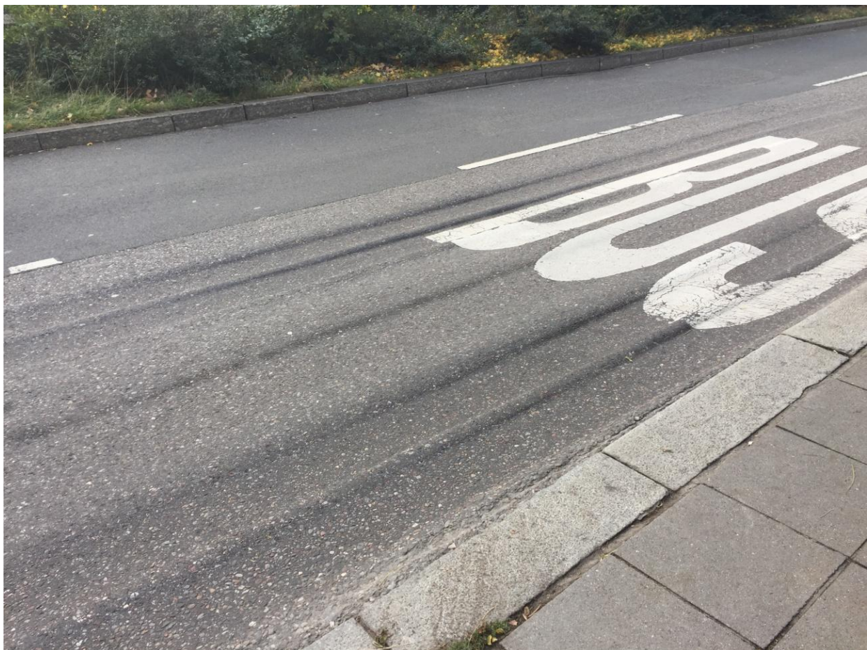
Bild 2: Fahrbahnschäden durch Spurrinnen
