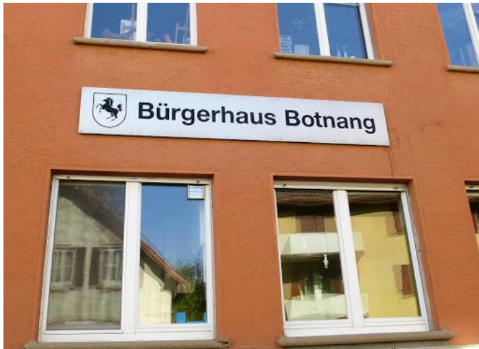
Abb. 9: Das Bürgerhaus in Botnang bedarf einer umfassenden Sanierung
