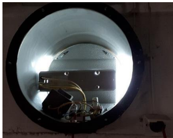
Bild 39 Unterwasserscheinwerfer alter Zustand
