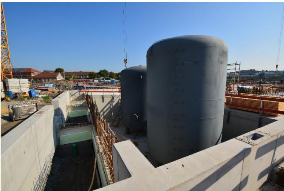
Bild 62 Energiezentrale mit Pufferspeicher
