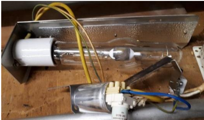
Bild 40 Unterwasserscheinwerfer alter Zustand- 400 W HQI Leuchtmittel
