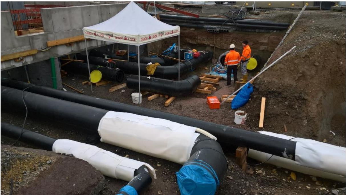
Bild 64 Anschluss der Glykol-Verbindungsleitungen
