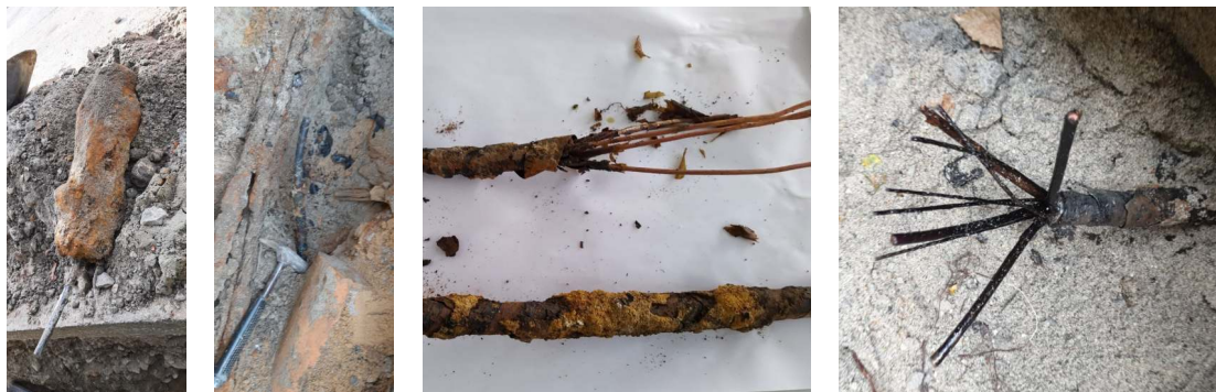
Abbildung 3.6: alte Niederspannungsmuffen, verschiedene Kabelarten und -schäden
