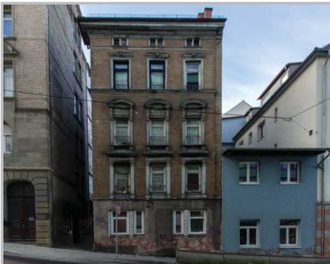
Wohngebäude mit Sanierungsbedarf (Foto: Matthias Strauß)
