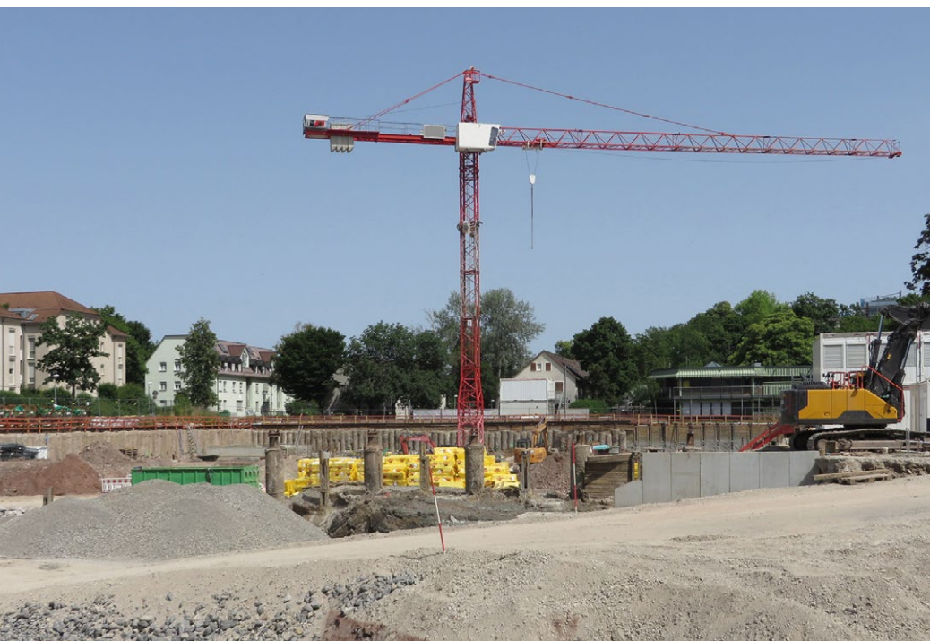
Baustelle in der Künzelsauer Straße im Stadtbezirk Zuffenhausen nach Ende der Altlastensanierung in der ehemaligen Keltersiedlung im Juni 2022 (Foto: Lutz Deutz)
