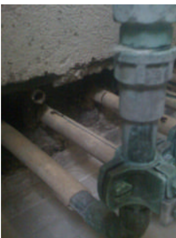
Wasserleitungen im Technikbereich
