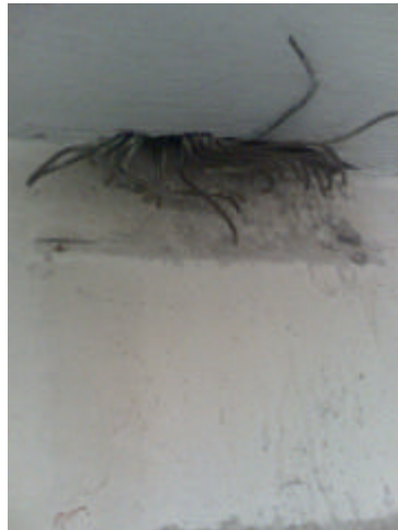
abgetrennte Stromkabel im Technikbereich
