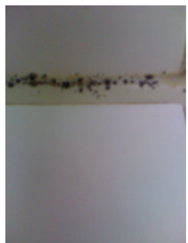
Silikonfuge im Bereich der Duschen bei den Jungen
