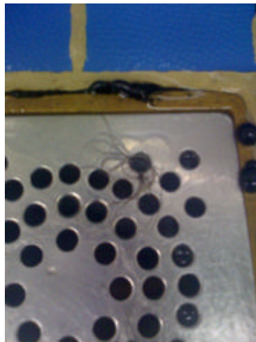
Abflussdeckel im Bereich der Duschen der Mädchen
