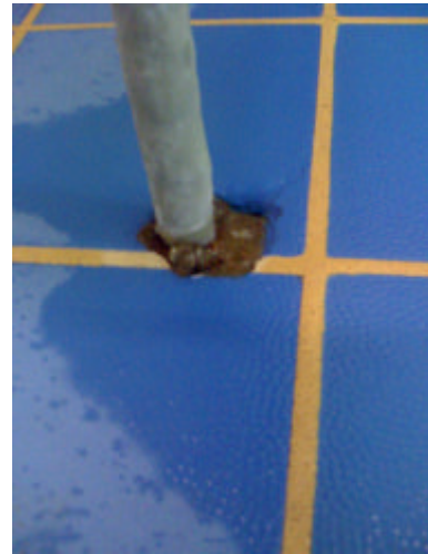
Fuß einer Duschkabinenabtrennung im Bereich der Duschen der Jungen
