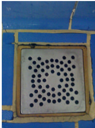
Abflussdeckel im Bereich der Duschen der Jungen
