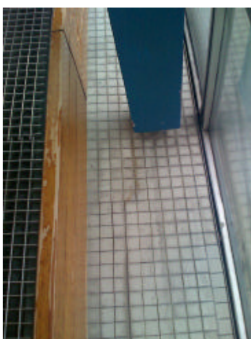
Boden um einen Deckenpfeiler im Schwimmbeckenbereich
