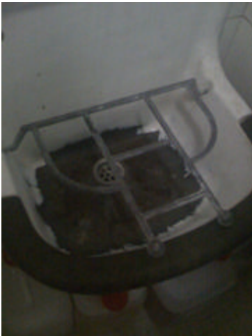
Washbecken im Technikbereich
