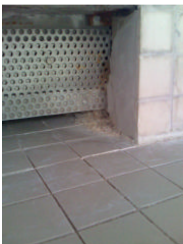
Bodenlüftungsgitter im Schwimmbeckenbereich
