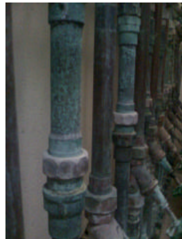
Wasserleitungen im Technikbereich
