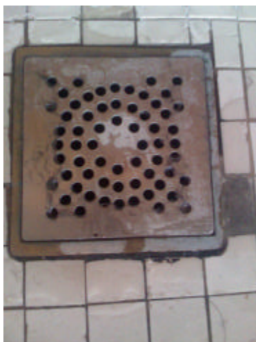
Abflussdeckel im Bereich der Duschen der Mädchen
