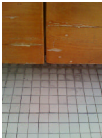
Heizungsabdeckung im Schwimmbeckenbereich
