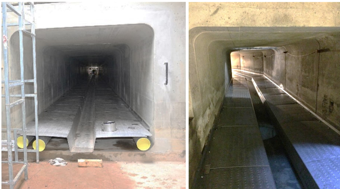
Abbildung 26 In Abwasserkanal eingebrachte Wärmetauscher
